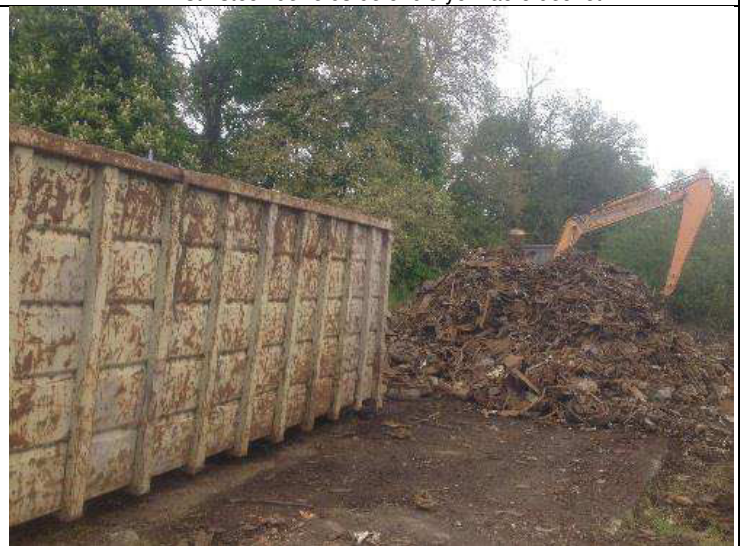
PFI Est : évacuation des refus de crible yc macro déchet en cours
